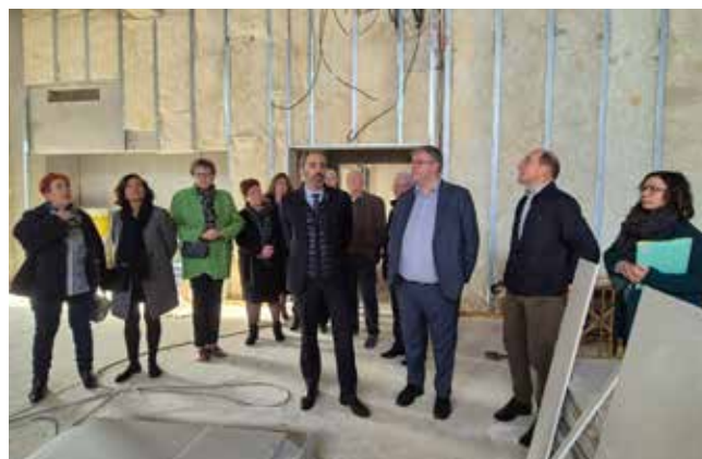
Les élus ont guidé Christophe Le Dorven au sein des futurs locaux de l'école municipale de musique. Ici dans le futur auditorium, avec notamment Daniel Desgrouas (2 ème à droite), adjoint au maire en charge du projet, et Sophie Aucante (1 ère à droite), architecte de l'agence Atelier Penneron, maître d'œuvre.
