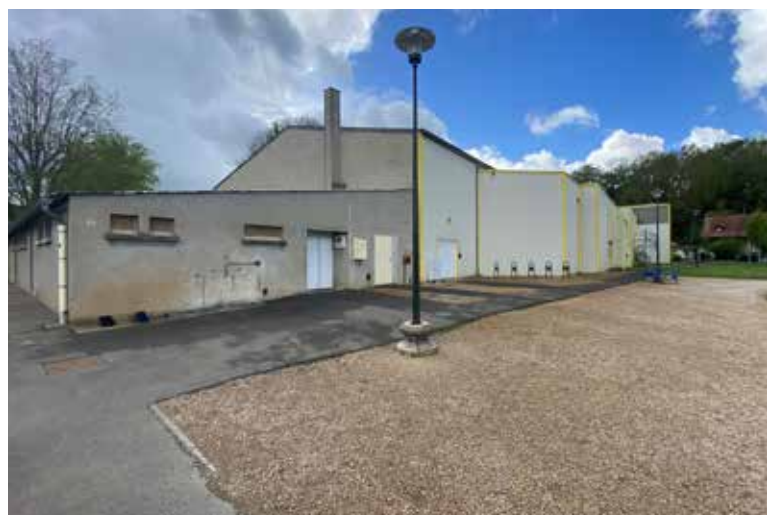
Les différents locaux offrent un aspect manquant de cohérence et nécessitent une rénovation complète, tant à l'intérieur qu'à l'extérieur.
