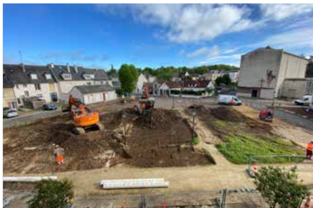
Evacuation de la terre, des gravats et du mobilier urbain place de l'Eglise.
