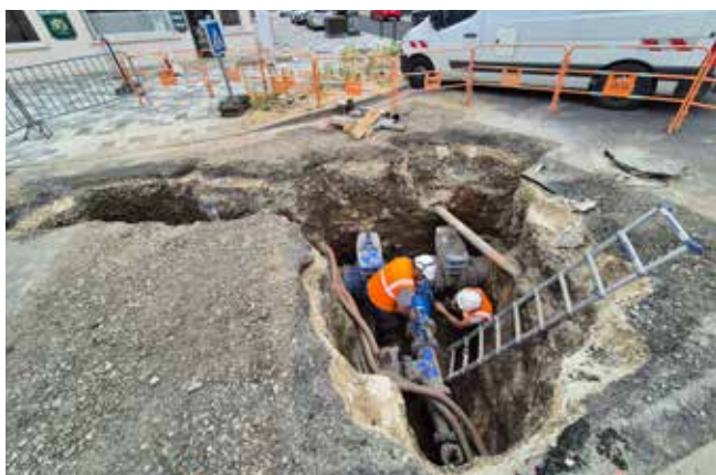
Connection et essais de pression sur le nouveau réseau d'adduction d'eau potable au début de la rue des Grands-Prés.
