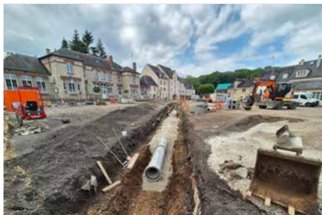
Pose du réseau d'évacuation des eaux pluviales, dont on mesure l'importance au regard de la taille des canalisations.
